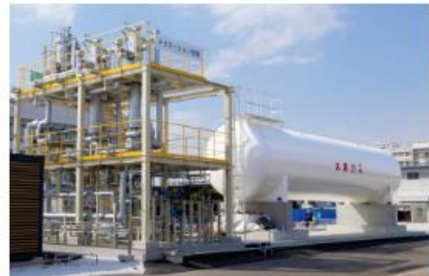
東京ガスが推進する都市ガスのメタネーション施設
